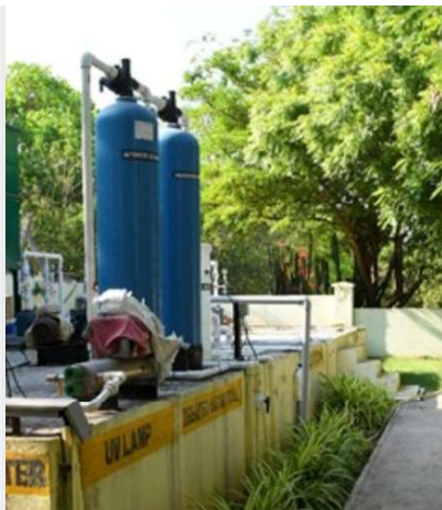
40 KLD STP & 90 KLD
